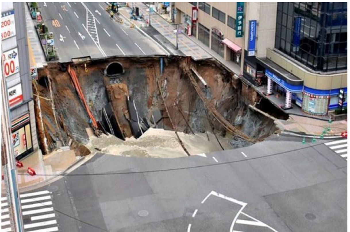
ภาพที่ ๙.๑ หลุมยุบ ในประเทศญี่ปุ่น ที่มา https://www.marumura.com/sinkhole-at-hakata-station/
