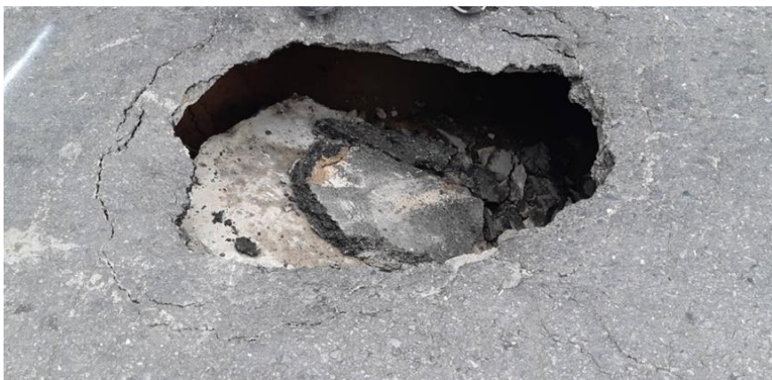
รูปที่ เหตุการณ์ถนนยุบ บริเวณถนนพระราม 4
