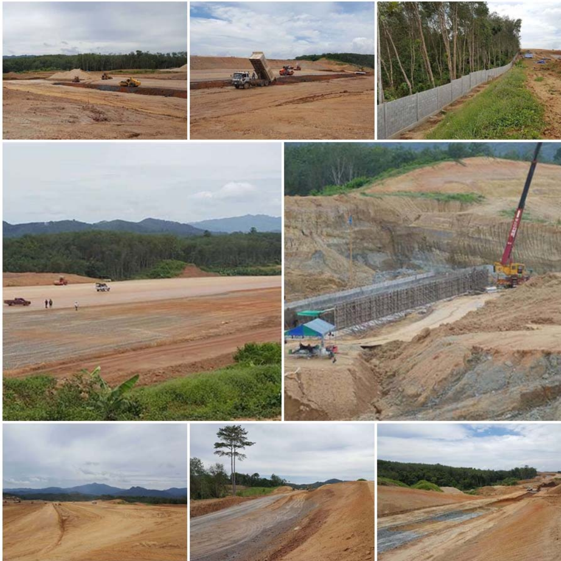
รูปที่ 11 ความคืบหน้าการก่อสร้างโครงการก่อสร้างทางวิ่ง ทางขับ ลานจอดเครื่องบินและอื่นๆ ท่าอากาศยานเบตง จังหวัดยะลา กรมท่าอากาศยาน
