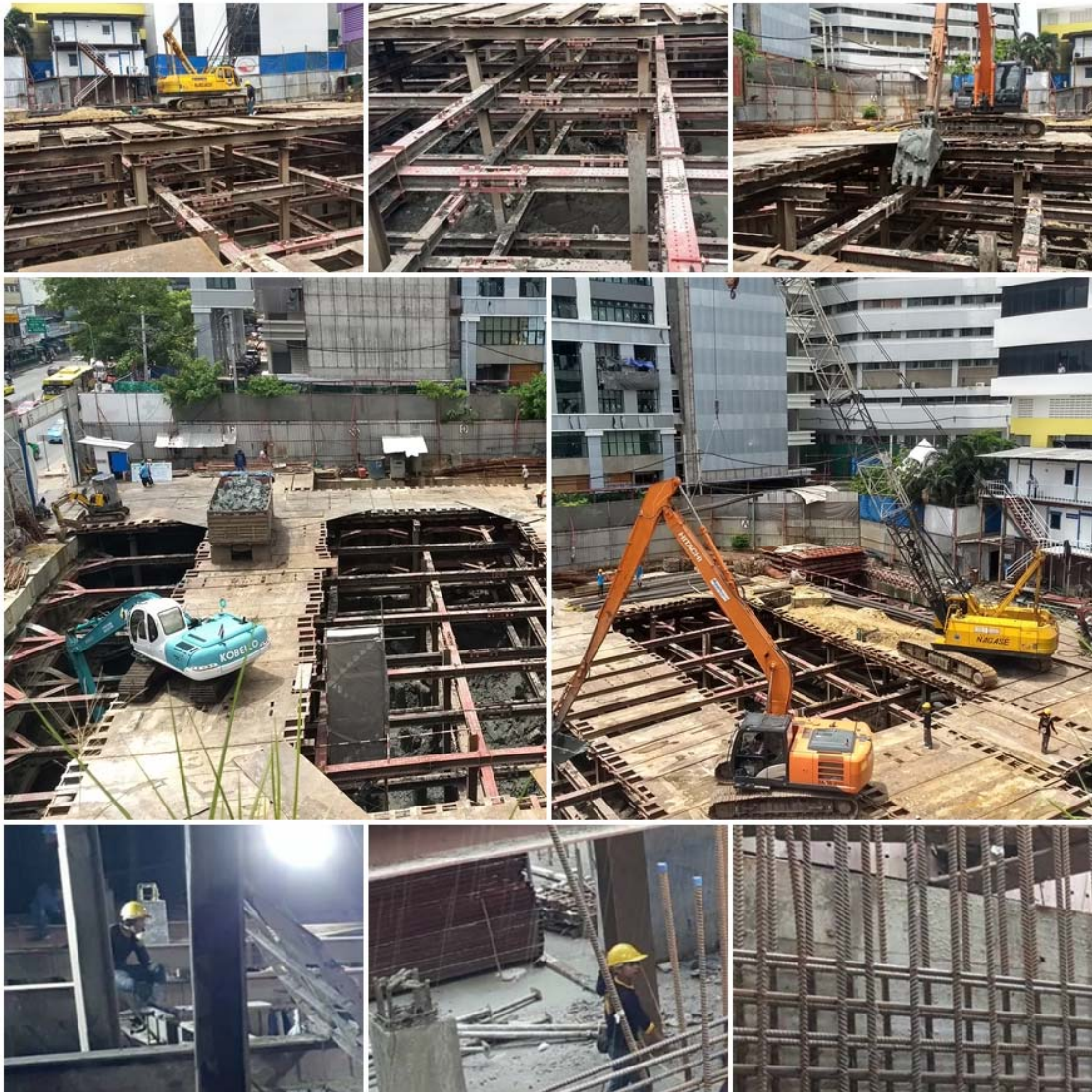
รูปที่ 12 ความคืบหน้าการก่อสร้างโครงการก่อสร้างอาคารสถาบันโรคผิวหนังพร้อมรื้อถอน
